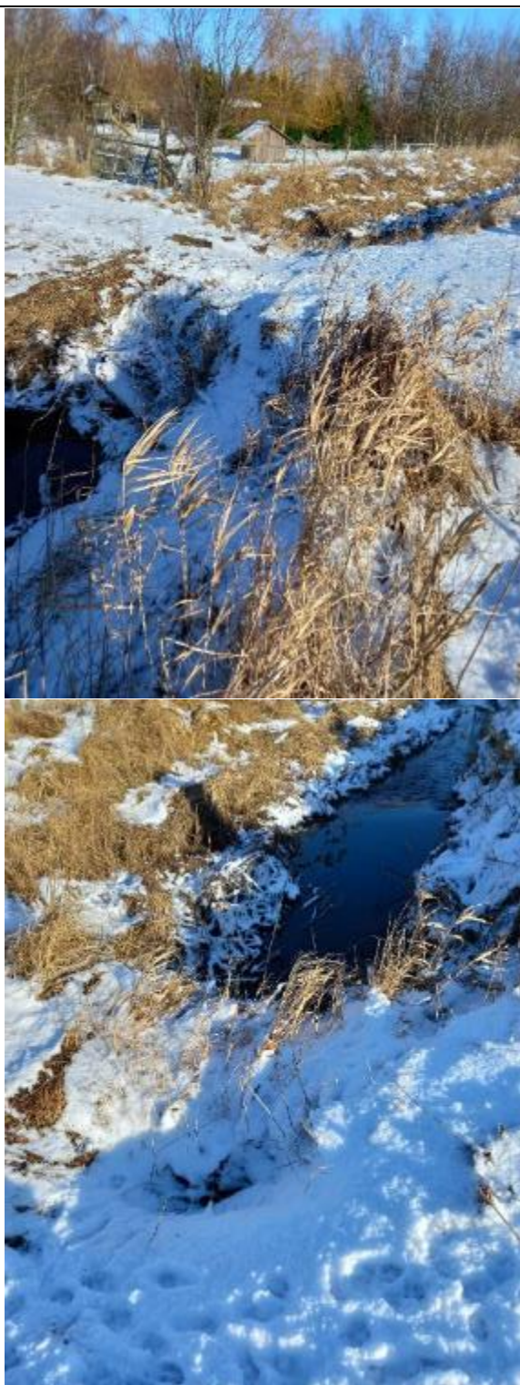
Foto 7. Overkørsel st. 364-369. Jordfaldshul i overkørslen
